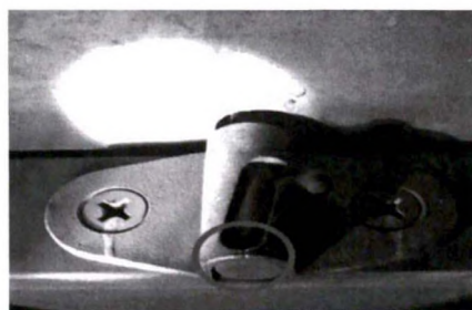
图1 底板弹簧销裂纹位置
