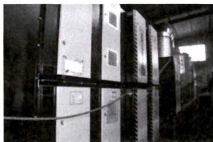
图4 中和+喷淋塔+过滤+多元复合光氧催化等离子+活性炭 废气处理设施
