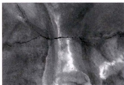
图6 实际裂纹扩展位置 Fig.6 Actual crack propagation location
